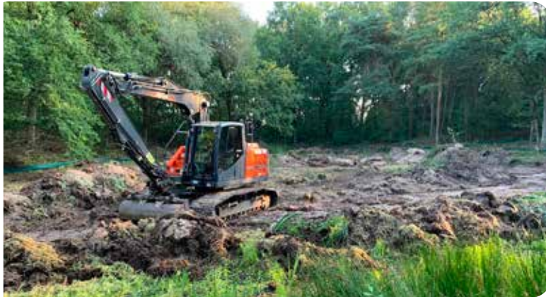
Die verlandeten Bereiche des Bracks „Kubelkakuhle“ wurden von der Firma „Fritz Siemers KG“ um bis zu einem Meter vertieft.
